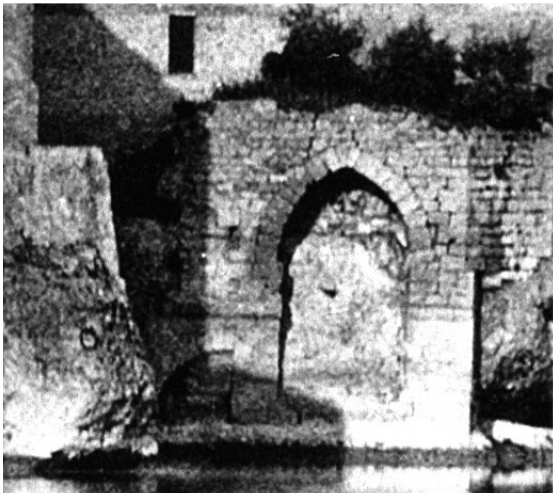
Detall de la fotografia anterior (any 1950). L'aspecte, patologies i vegetació a la part superior que presenta la zona de l'arc son molt similars als que presenta actualment.
