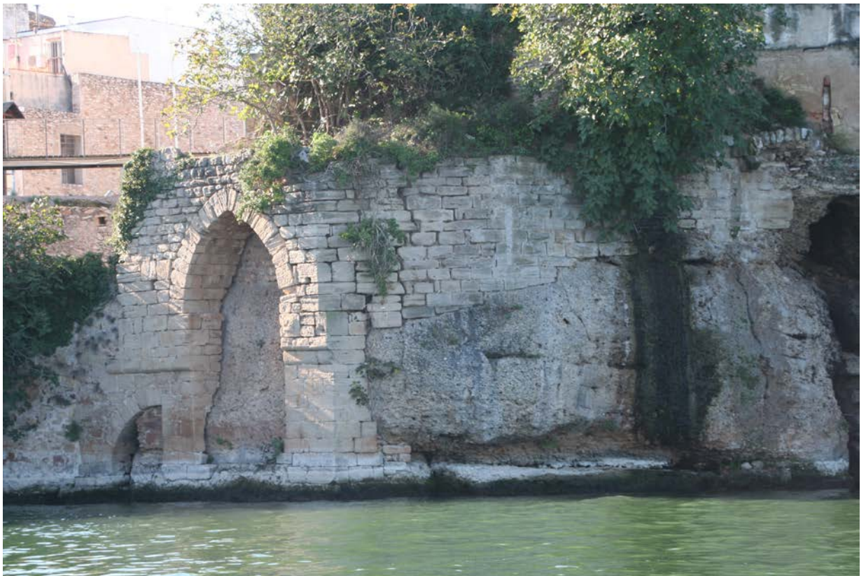
Vista des del riu dels panys (frontal i lateral de l'arc) objecte dels treballs de consolidació estructural i de restauració.
