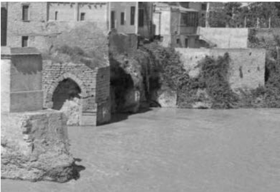
Detall de la foto anterior (meitat s.XX). S'observa l'estat de conservació de les estructures associades a l'arc i també dels murs antics de les construccions annexes.
