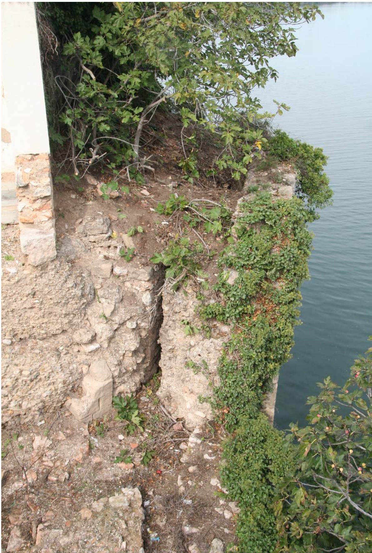
Vista lateral de la zona de l'arc gòtic en la que s'observa la posició de les construccions adjacents i l'esquerda generada pel moviment del pany de mur.
