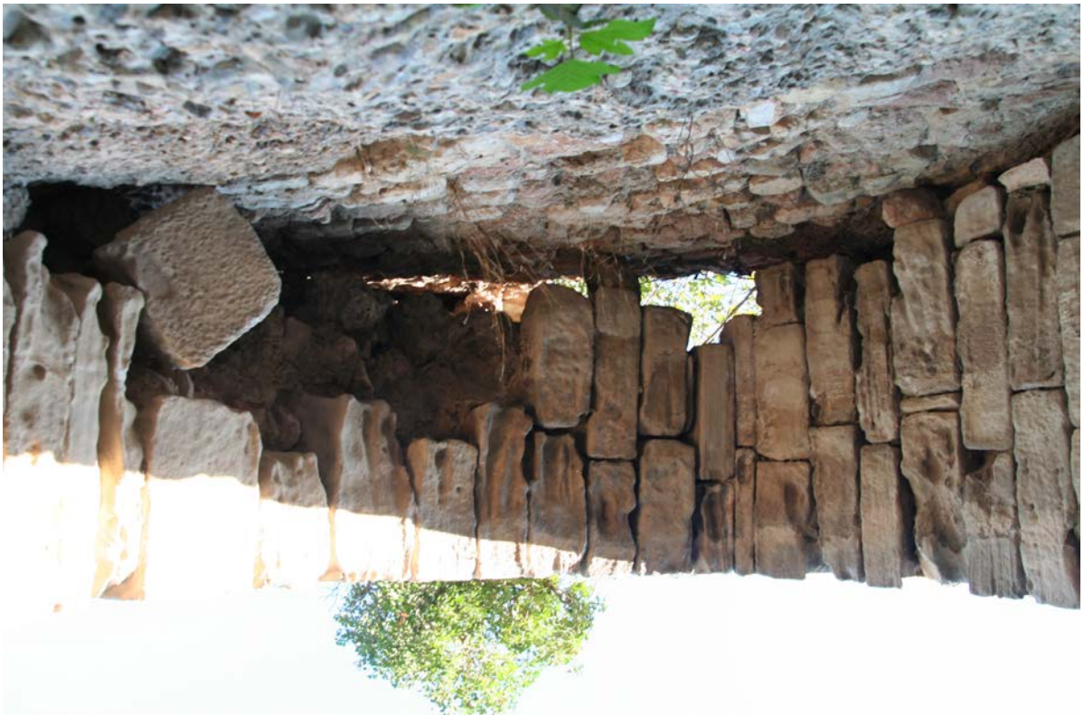
Vista inferior de l'arc gòtic en la que s'observa la separació amb la roca i muralla adjacent i la pèrdua de dovelles generada pel seu moviment.
