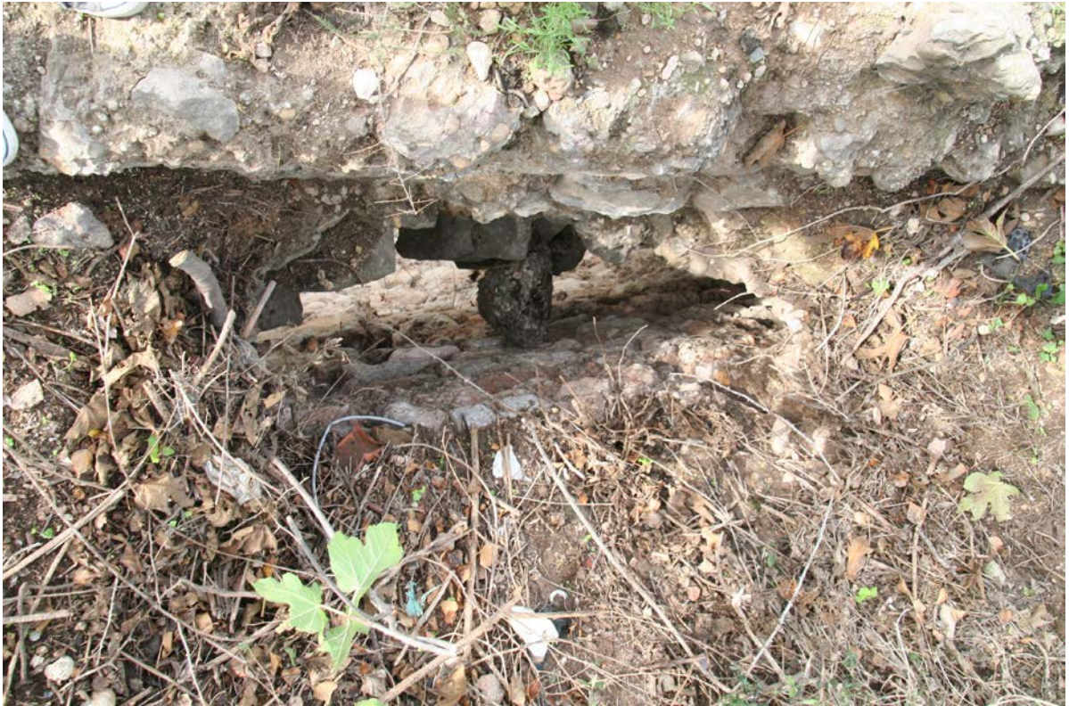
Detall del forat entre el mur andalusí i el pany de l'arc gòtic generat pel moviment d'aquest últim.
